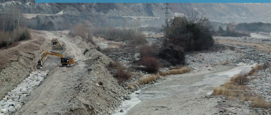
Als «Fundament» des Dammes dient ein Blockwurf. 3-6 Tonnen schwere Blöcke als Barriere gegen Hochwasser (Nov. 2017).
