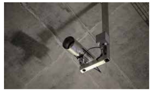
Alle 150 m ist im Tunnel Eyholz eine Videokamera installiert.
