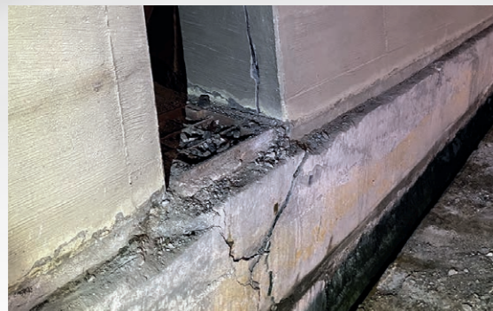
Durch natürliche Spannungsumlagerungen beim Bau der Nordröhre entstandene Risse am Gewölbefuss des bestehenden Vispertaltunnels.
