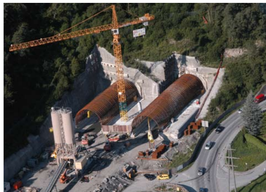
Beim Ostportal des Tunnels Riedberg wurden die stärksten Rutschungen gemessen.
