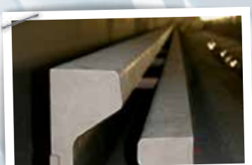
Eine Schlitzrinne im Gedeckten Einschnitt Turtmann: Sie dient zur Entwässerung der Fahrbahn.
