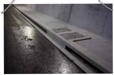
Bankett noch ohne Gussasphalt, mit Schacht und Schlitzrinne zur Entwässerung der Fahrbahn.
