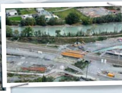
Die im Juli 2014 versetzten Stahl-Hilfsbrücken für die SBB-Bahnlinie machen den Bau der Unterführung erst möglich. (Foto: Swissgas)
