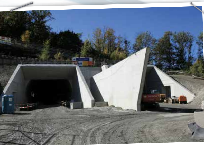
Das Portal Grosshüs im Osten des Tunnels Eyholz. Zwischen den beiden Portalen: die Antirezirkulationswand.
