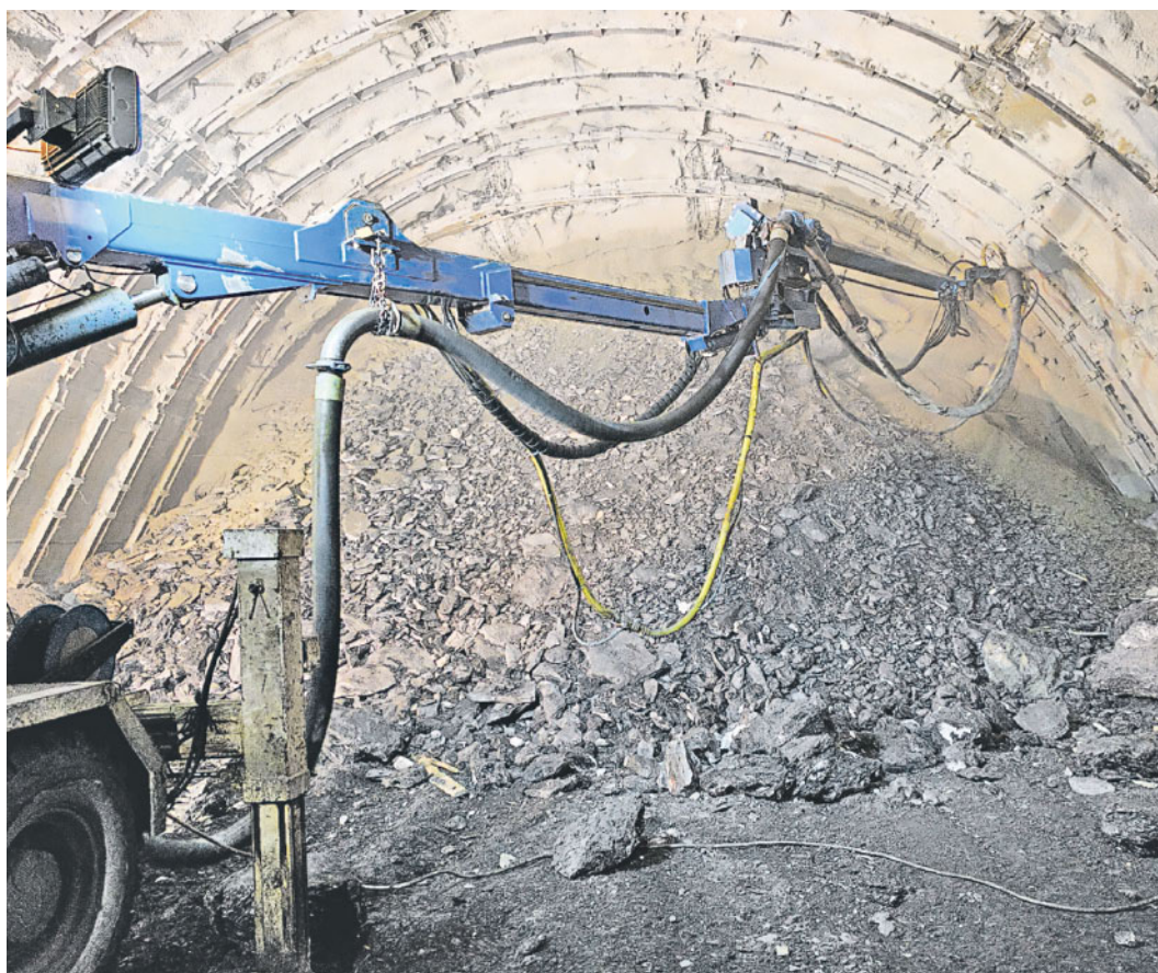
Niederbruch. Am 11. Februar brachen rund 600 Kubikmeter Fels in den Tunnel Visp ein.
