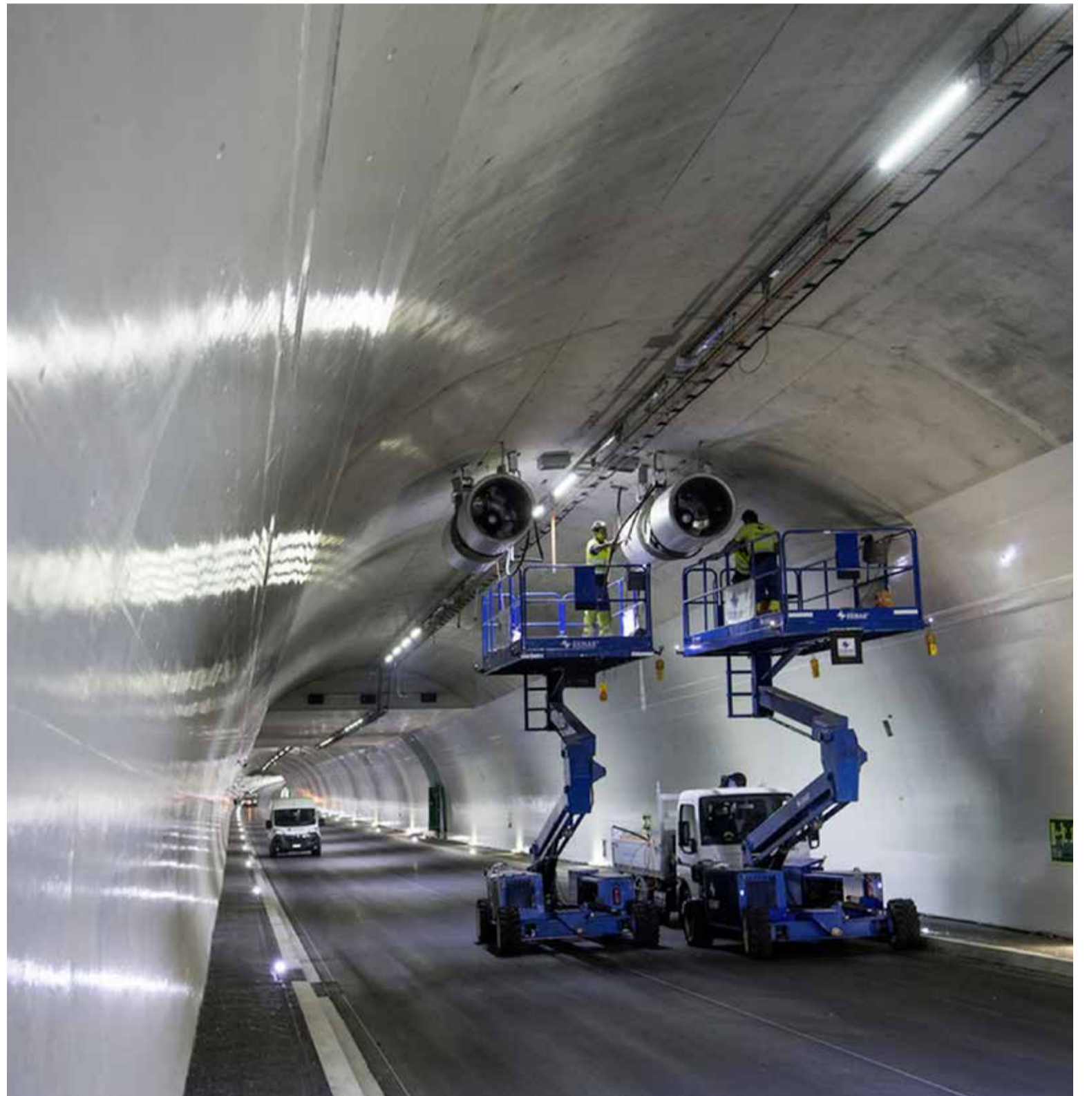
Messungen. Wenige Monate nach Eröffnung der beiden Tunnelröhren sind Hebungen und Senkungen der Röhren festgestellt worden.
