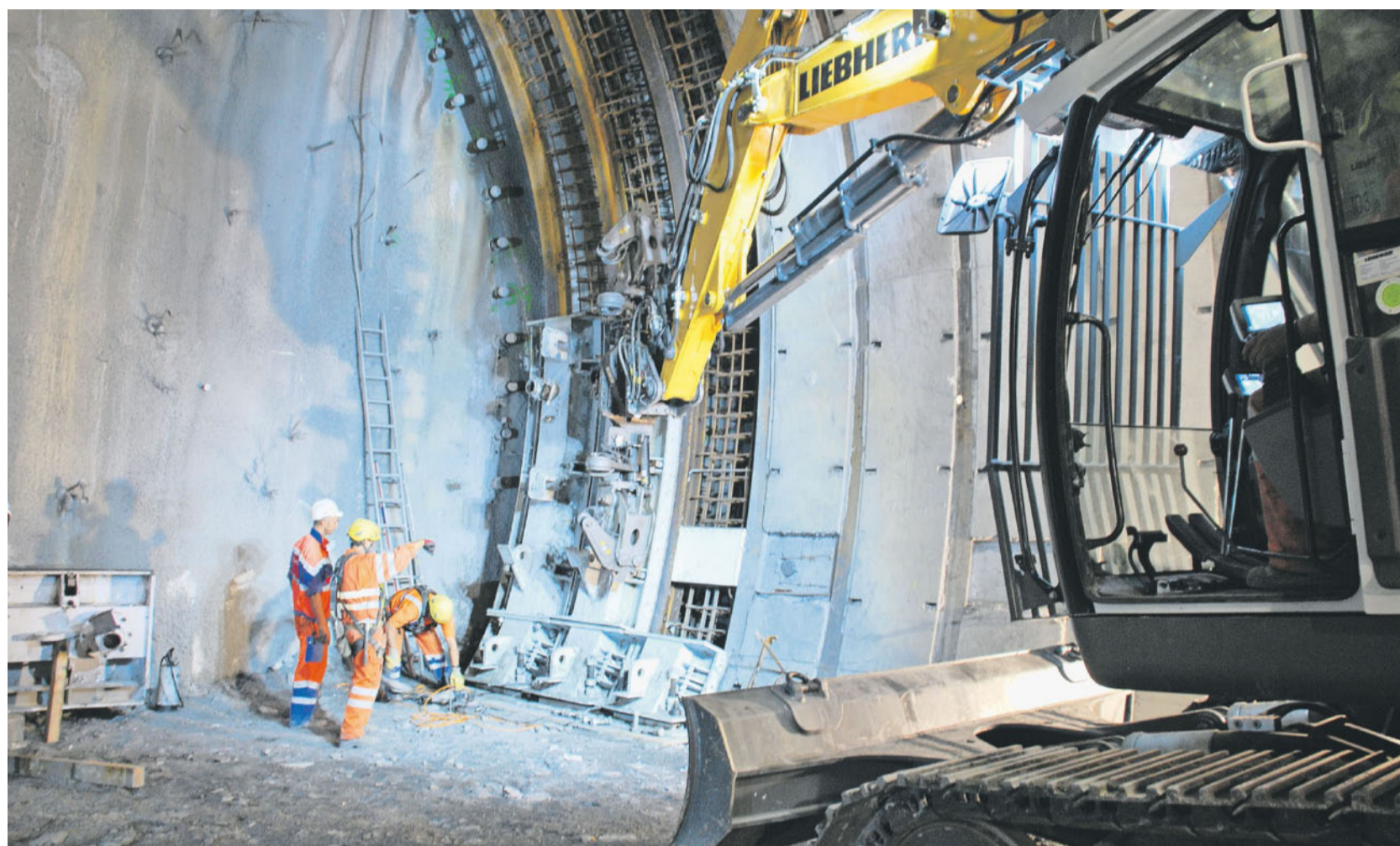
Aufwendig. Tunnelarbeiter montieren stählerne Schalungselemente für das Einbringen des Betons, welcher den sogenannten Rohrschirm bildet. FOTO WB
